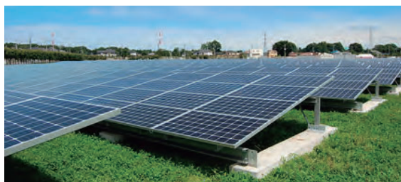
鶴ヶ島太陽光発電所
